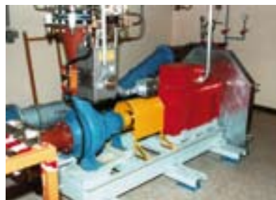
Bild 8: Umkehrpumpe als Turbine in der Wasserversorgung von Morges (VD); man beachte das Schwungrad unter der Verschalung (rechts im Bild), welches die Druckstösse dämpfen hilft. (Quelle: J-M Chapallaz, Baulmes)
